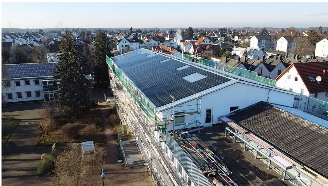
Blick auf das TSE-Gebäude und die neue Solaranlage (Bild: BFP)
